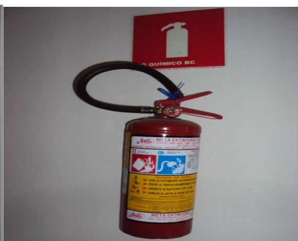
Extintor de Incêndios
