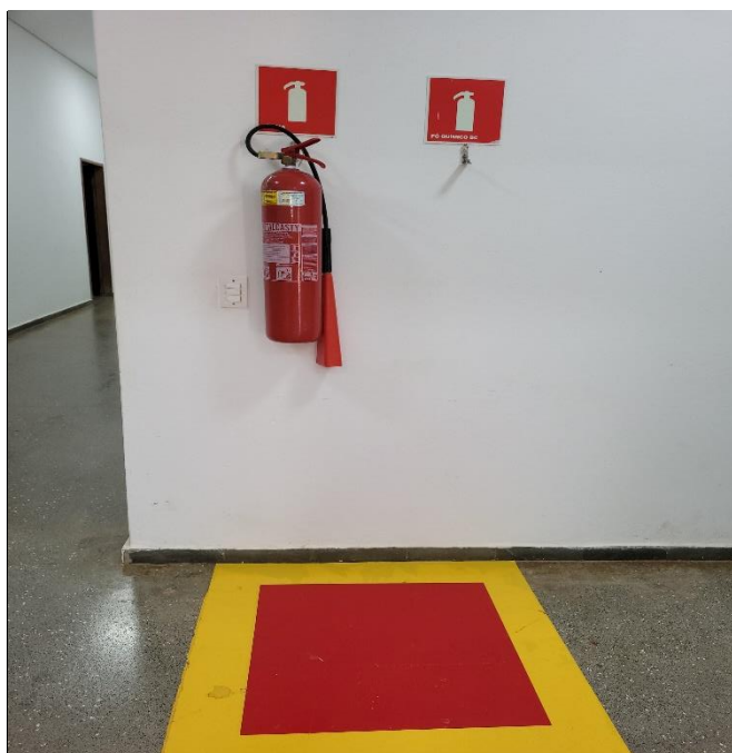
Extintor de Incêndio
