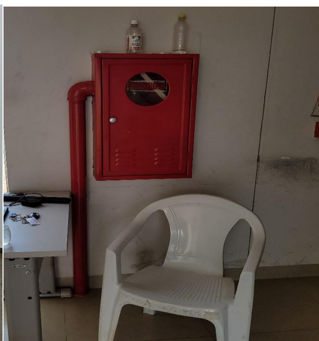
Rede de Hidrantes
