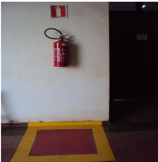
Extintor de Incêndio
