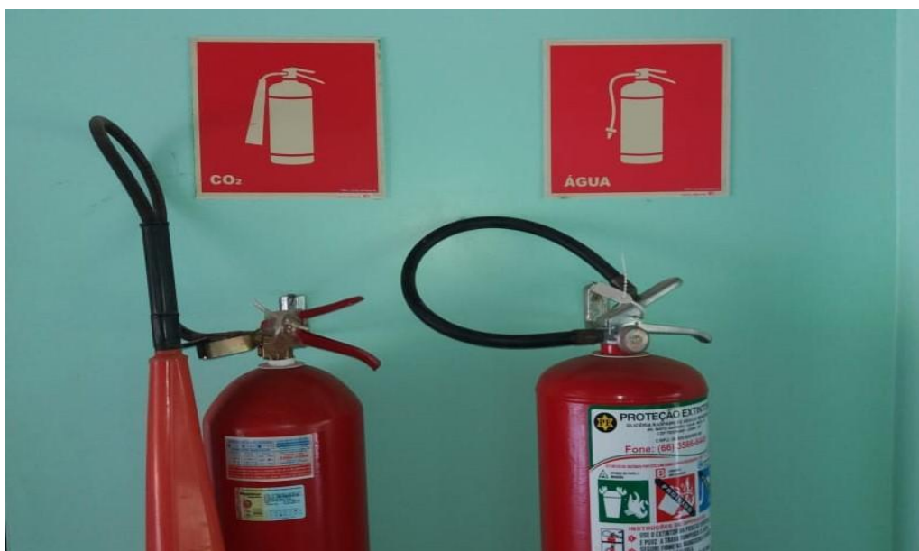
Sinalização e identificação de extintores de emergência, Campus de Juara
