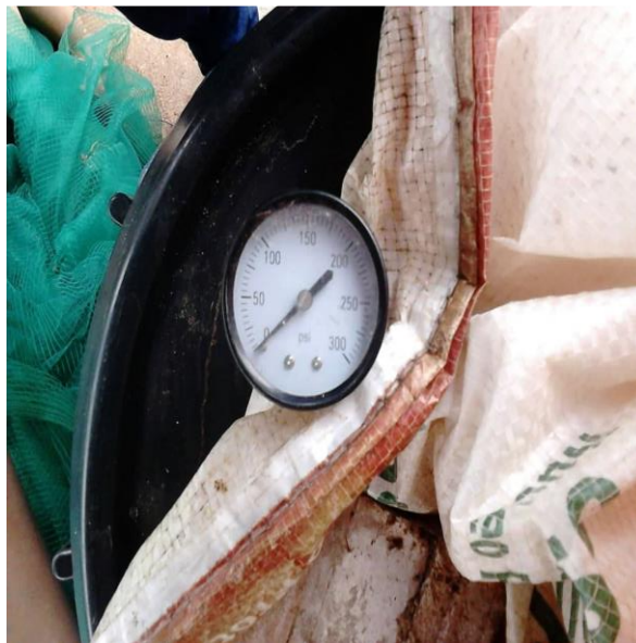
Figura 6. Manômetro (medidor de pressão)
