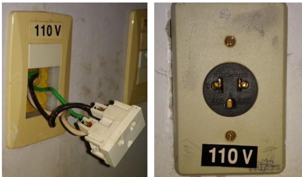
Figura 31: Condutores expostos e tomadas fora do padrão.
