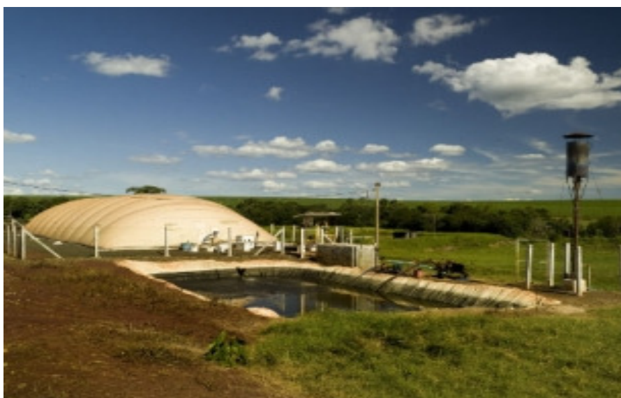
Figura 2: Tanque de armazenamento para esterco líquido. Fonte: RECICLAGEM de dejetos de animais é exemplo em fazendas dos EUA, 2010.
