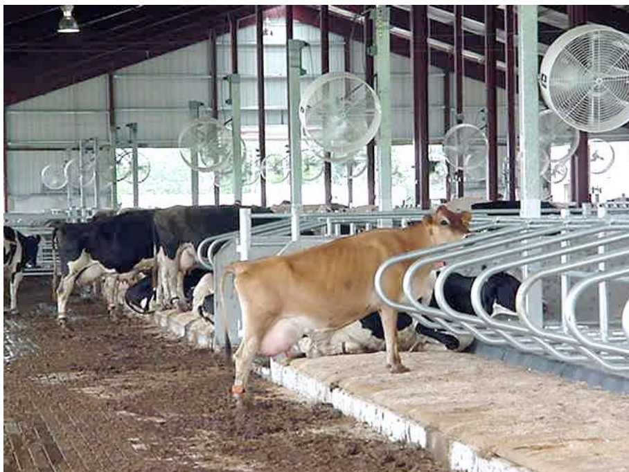
Figura 3 Ventilação mecânica – ventilador axial
