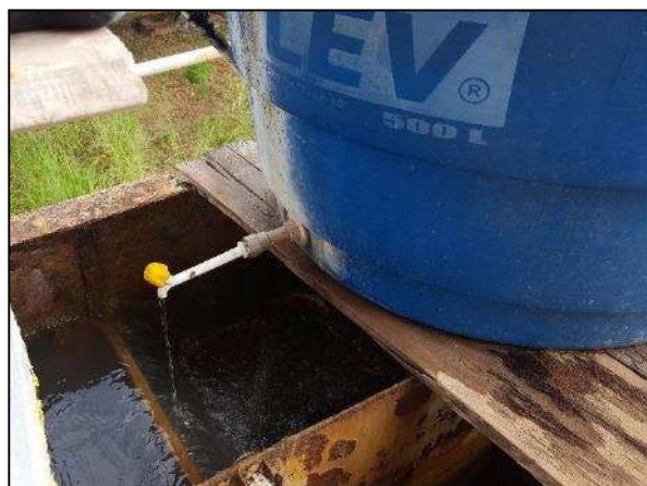
Figura 114. Aplicação do polímero no floculador na ETA de Assari
