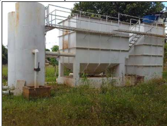
Figura 112. ETA compacta metálica no distrito de Assari
