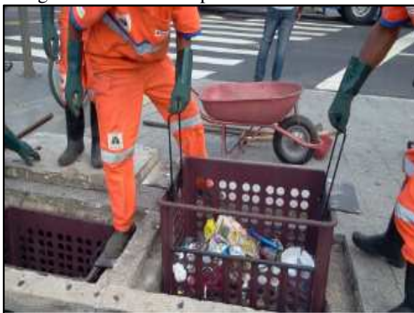
Figura 168. Cesta acoplada a boca do bueiro
