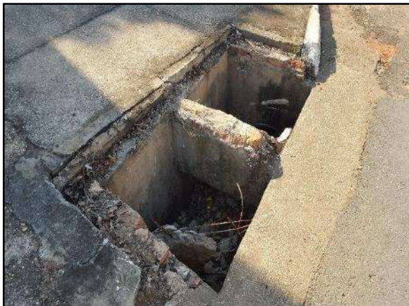
Figura 60. Boca de lobo assoreada na Rua A (7)
