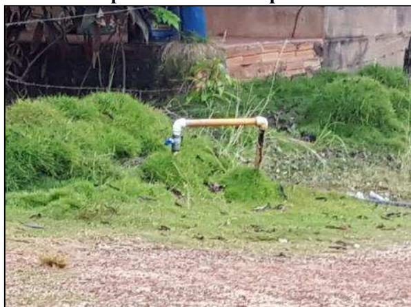
Figura 128. Cavalete sem hidrômetro no povoado de Currupira
