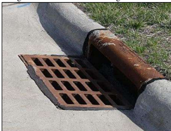
Figura 169. Boca de lobo com gradeamento
