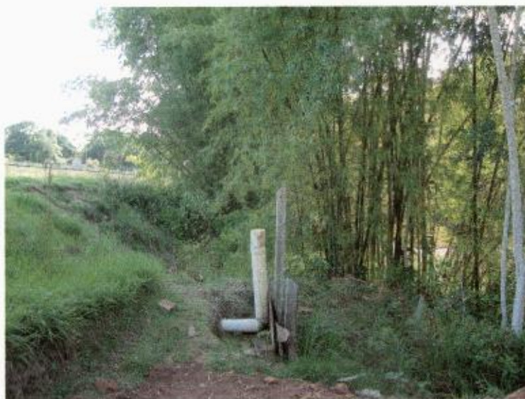
Figura 7: Sistema de escoamento de água por cano PVC no município de Comodoro - MT.
