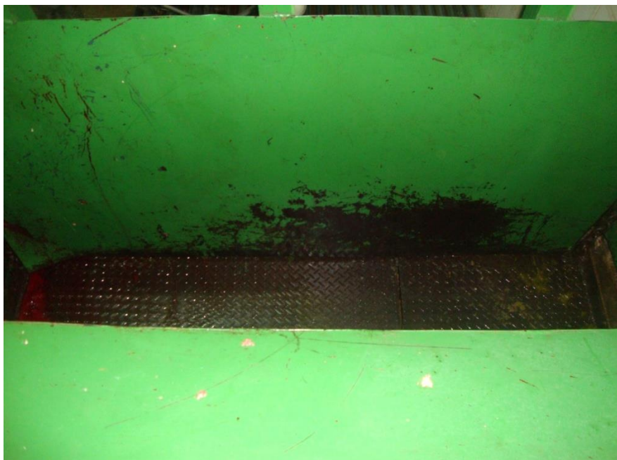
Figura 5: Box de contenção
